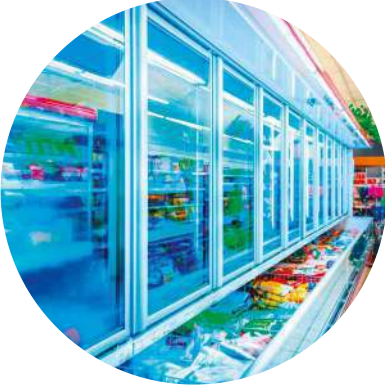
Soğutma ve HVAC
